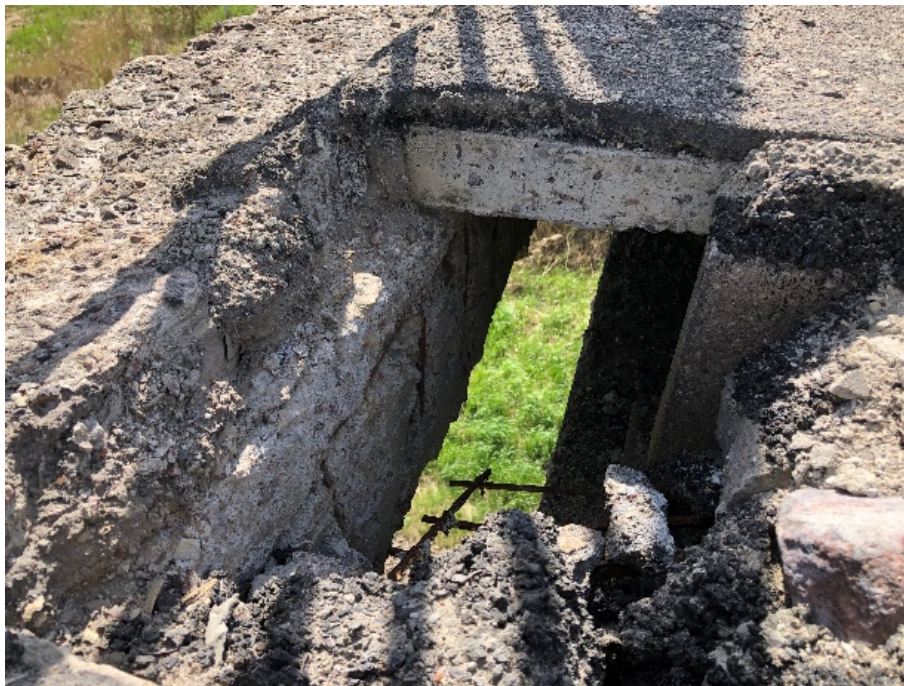
6 pav. Pažeisti, ištrupėję viaduko šalitulčiai
