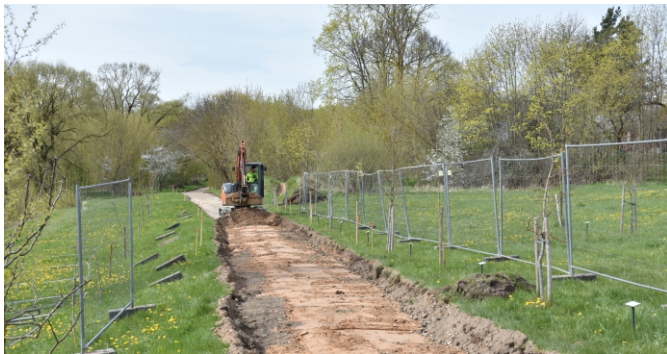
Gerinta dviračių takų infrastruktūra – modernizuota dalis pėsčiųjų ir dviračių tako link Berčiūnų
