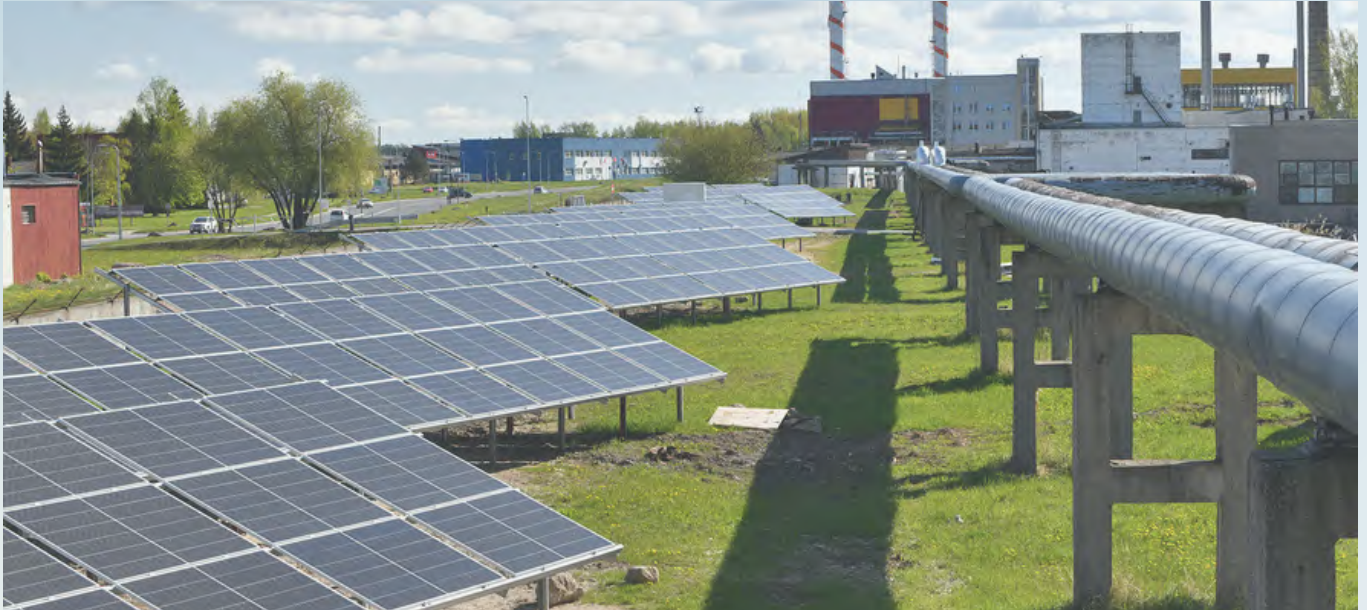
Saulės fotovoltinė elektrinė (249 kW galios) Panevėžys
